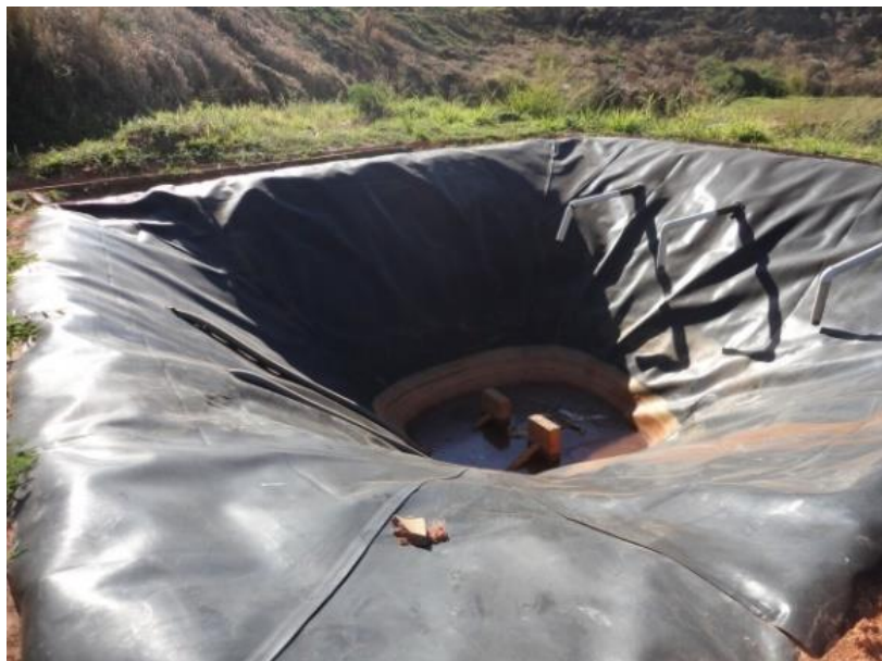
Figura 141 - Sistema de tratamento de lixiviados por Lagoa de Estabilização.
