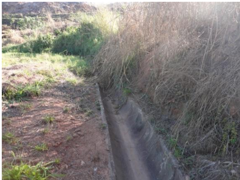
Figura 137 - Valas de drenagem sem a limpeza adequada.
