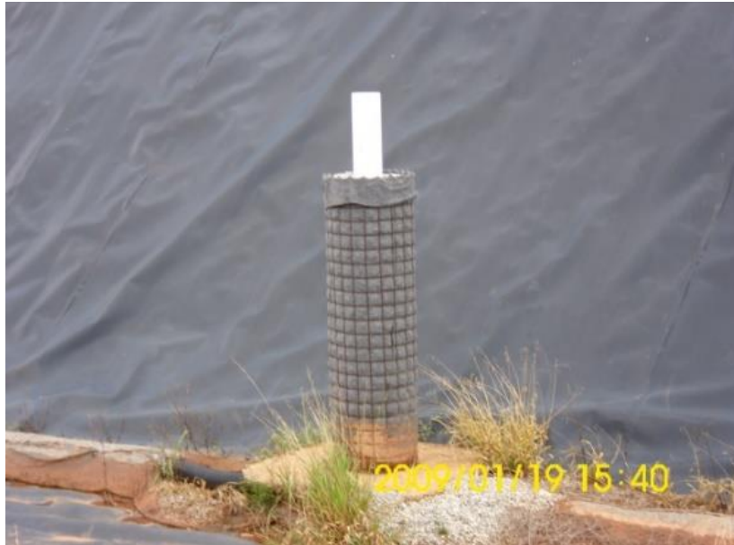
Figura 133 - Drenagem e queimador do gás.
