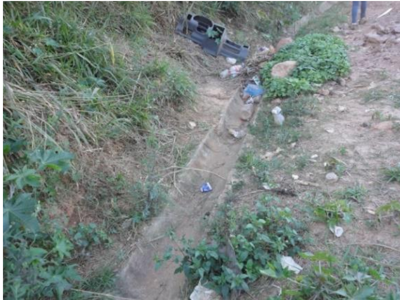
Figura 136 - Valas de drenagem sem a limpeza adequada.
